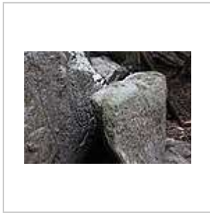
浄瑠璃寺奥之院瑠璃 不動磨崖仏(下半身 の前に剥落した上半 身がずり落ちてい る)
